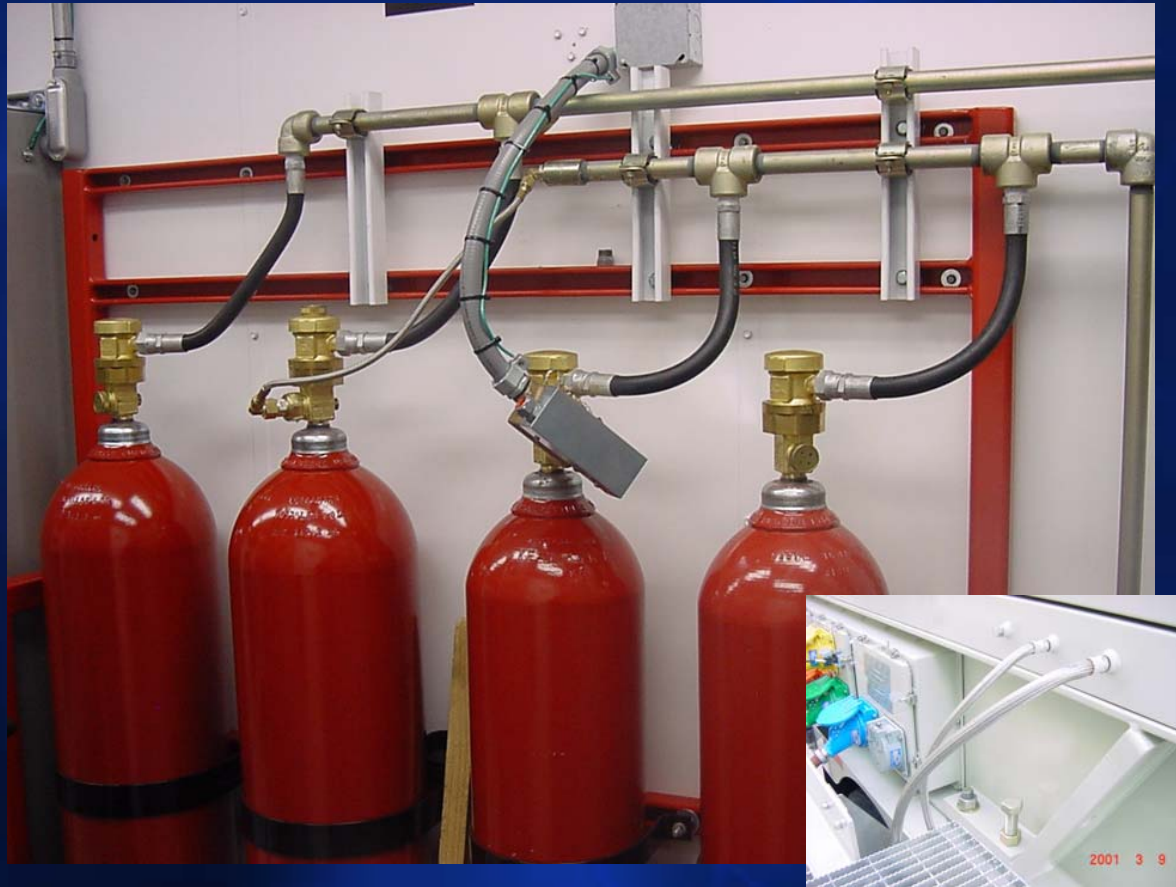
CO2 Fire System
